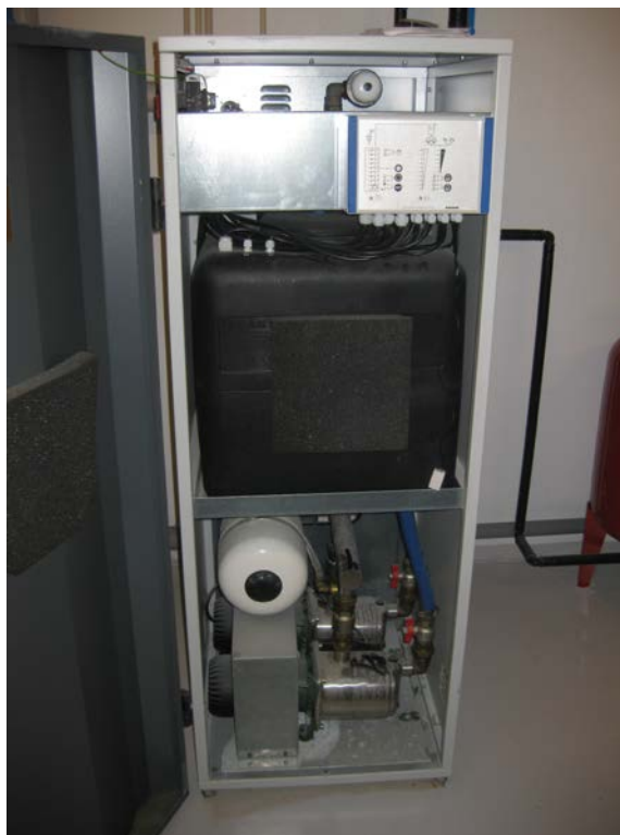
Figur 5 Styringsystemet i teknikrummet
